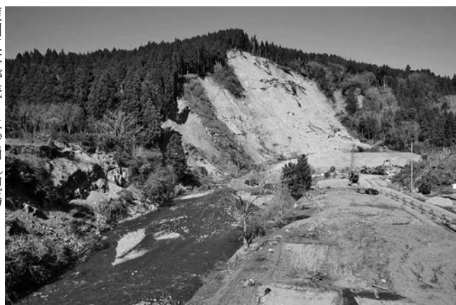
復旧工事が続く土砂崩れ現場
